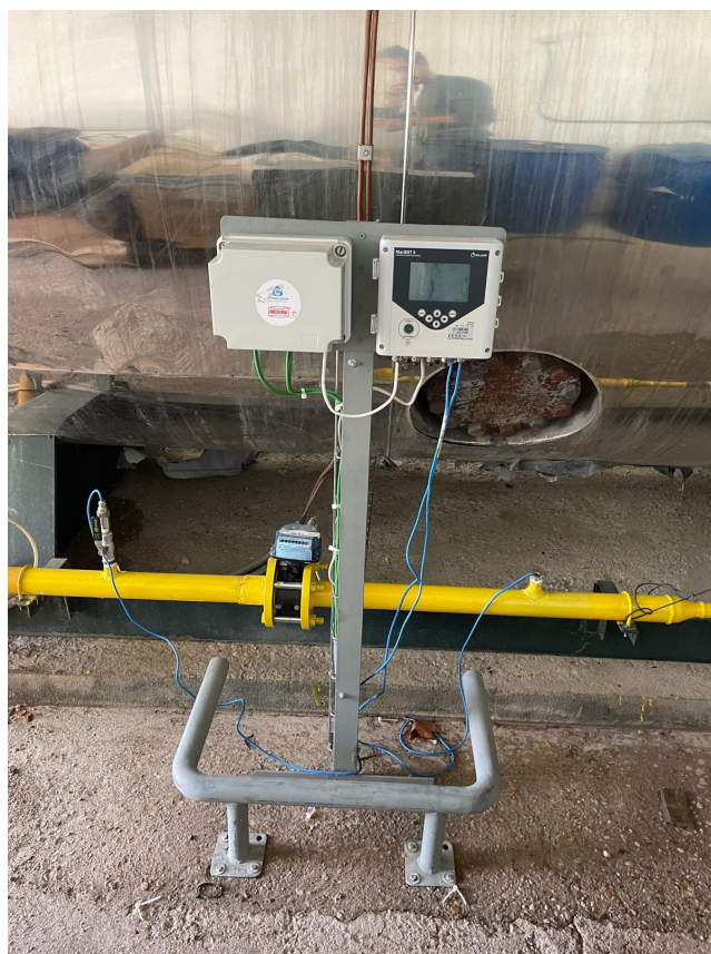
IMAGEN CONTADOR DE GAS CON CORRECTOR DE TEMPERATURA Y PRESION CLIENTE US_3
