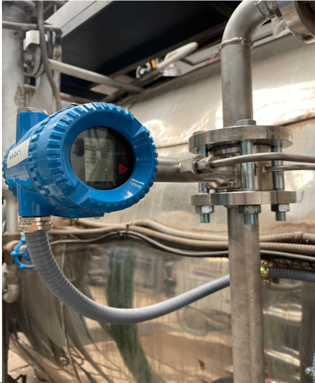
IMAGEN CAUDALIMETRO AGUA ALIMENTACIÓN CALDERA CLIENTE US_3
